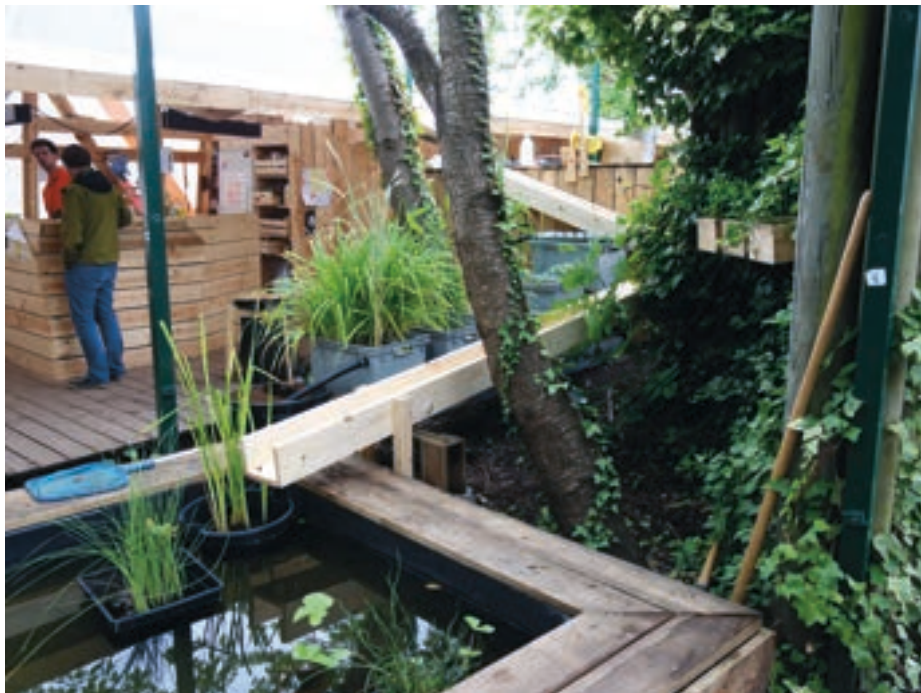
Le système de filtration des eaux grises / Grey waters filtration system
